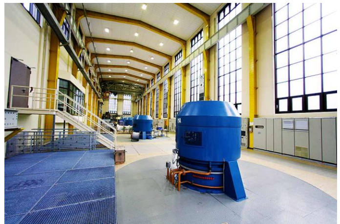
Die vier Generatoren des Kraftwerks Häusern erzeugen im Jahresdurchschnitt 120 Mio. kWh Strom damit könnten theoretisch 35.000 Haushalte versorgt werden.
